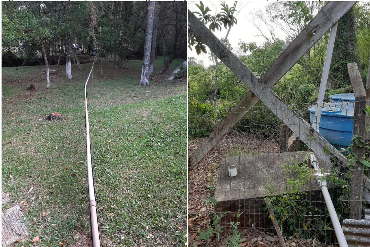
Figura 90: Tubulação que direciona a água do poço aos reservatórios e poço de recalque - 09/2020.
