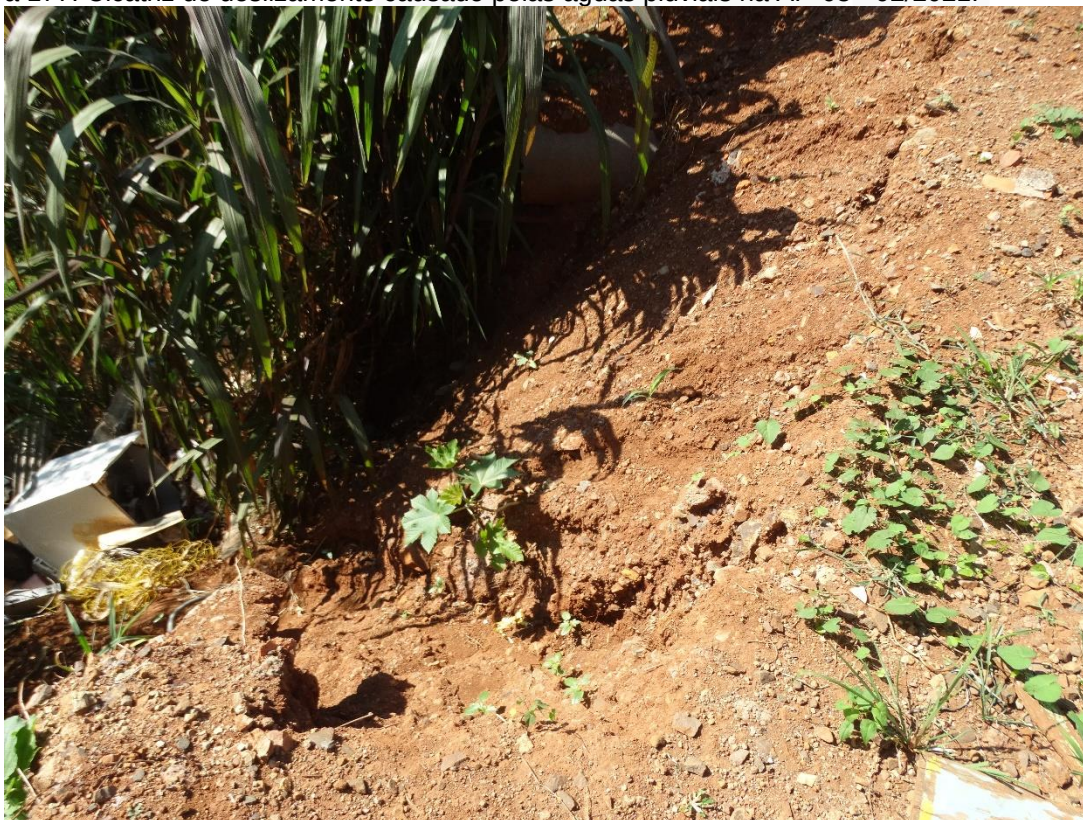
Figura 177: Cicatriz de deslizamento causado pelas águas pluviais na AP-03 - 02/2021.
