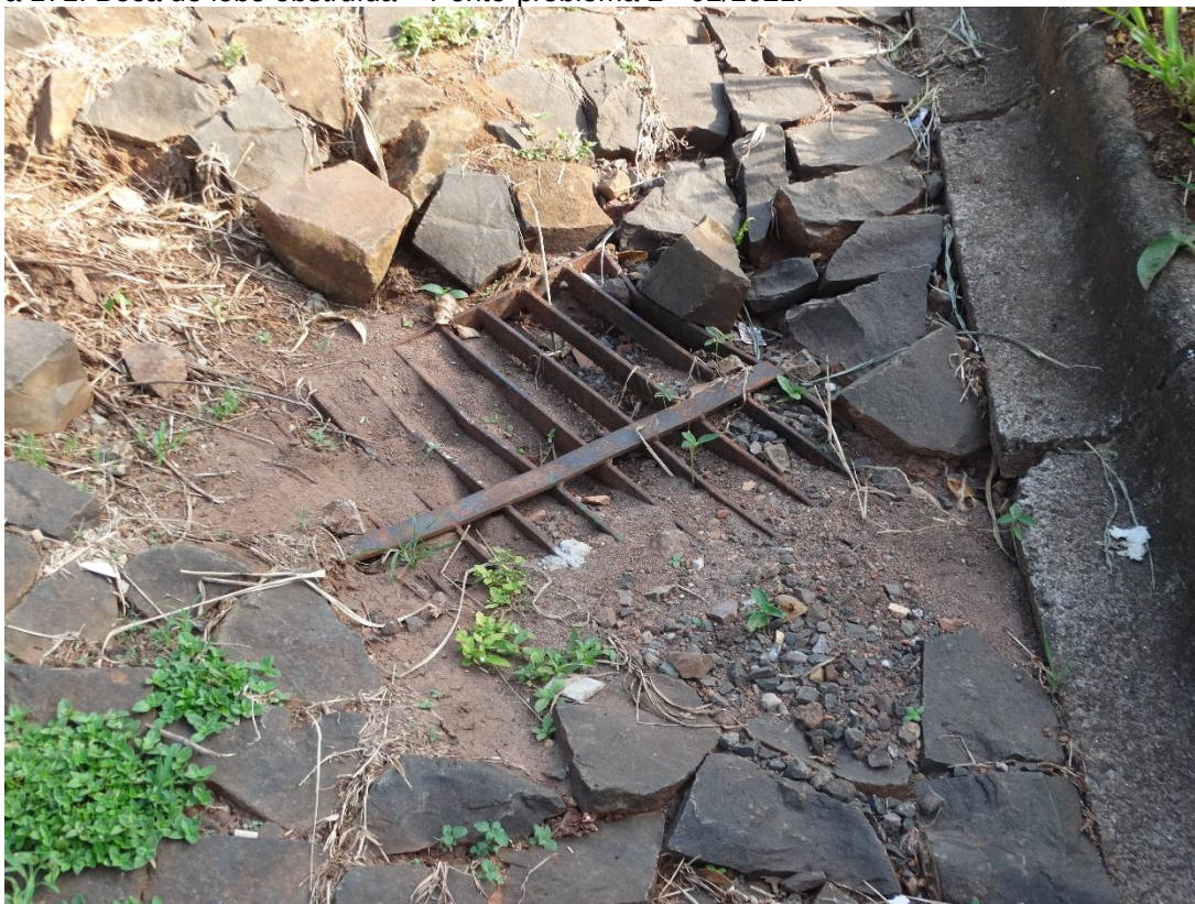
Figura 171: Boca de lobo obstruída – Ponto-problema 2 - 02/2021.
