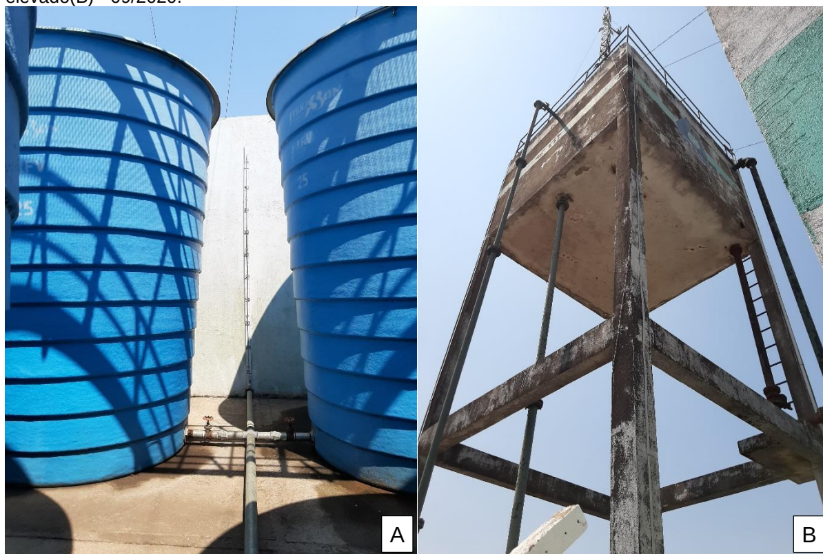
Figura 44: Reservatório R.3a – 4 x 25 m 3 PRFV apoiado (A) e Reservatório R.3b – 30 m 3 em concreto elevado(B) - 09/2020.
