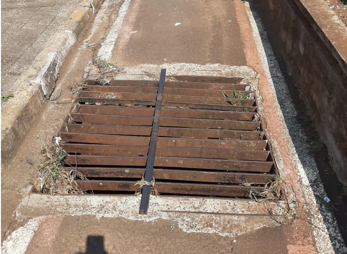
Figura 158: Modelo de boca de lobo instalado no Município - 09/2020.
