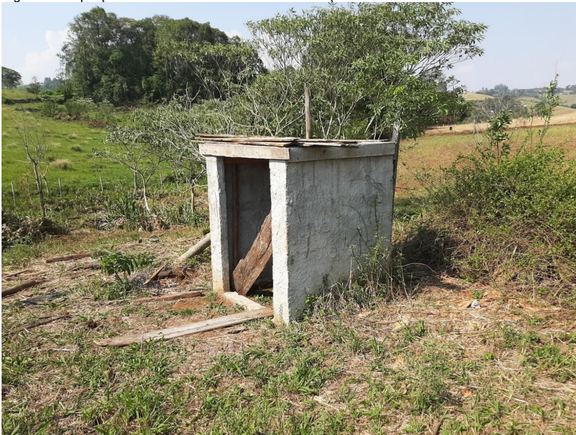
Figura 72: Captação Linha Santana da Bela Vista – Poço - 09/2020.
