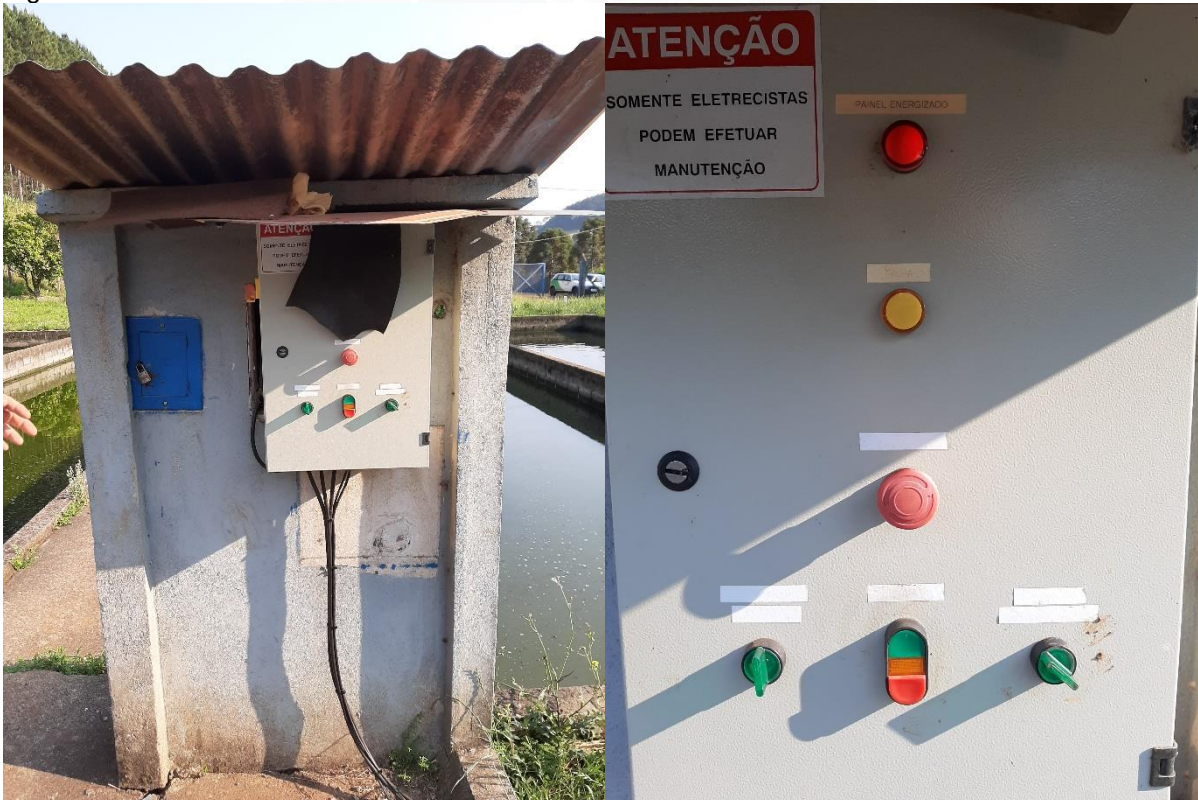
Figura 98: Painel de Controle – Lodos Ativados – ETE – SES Bairro São Francisco - 10/2020.
