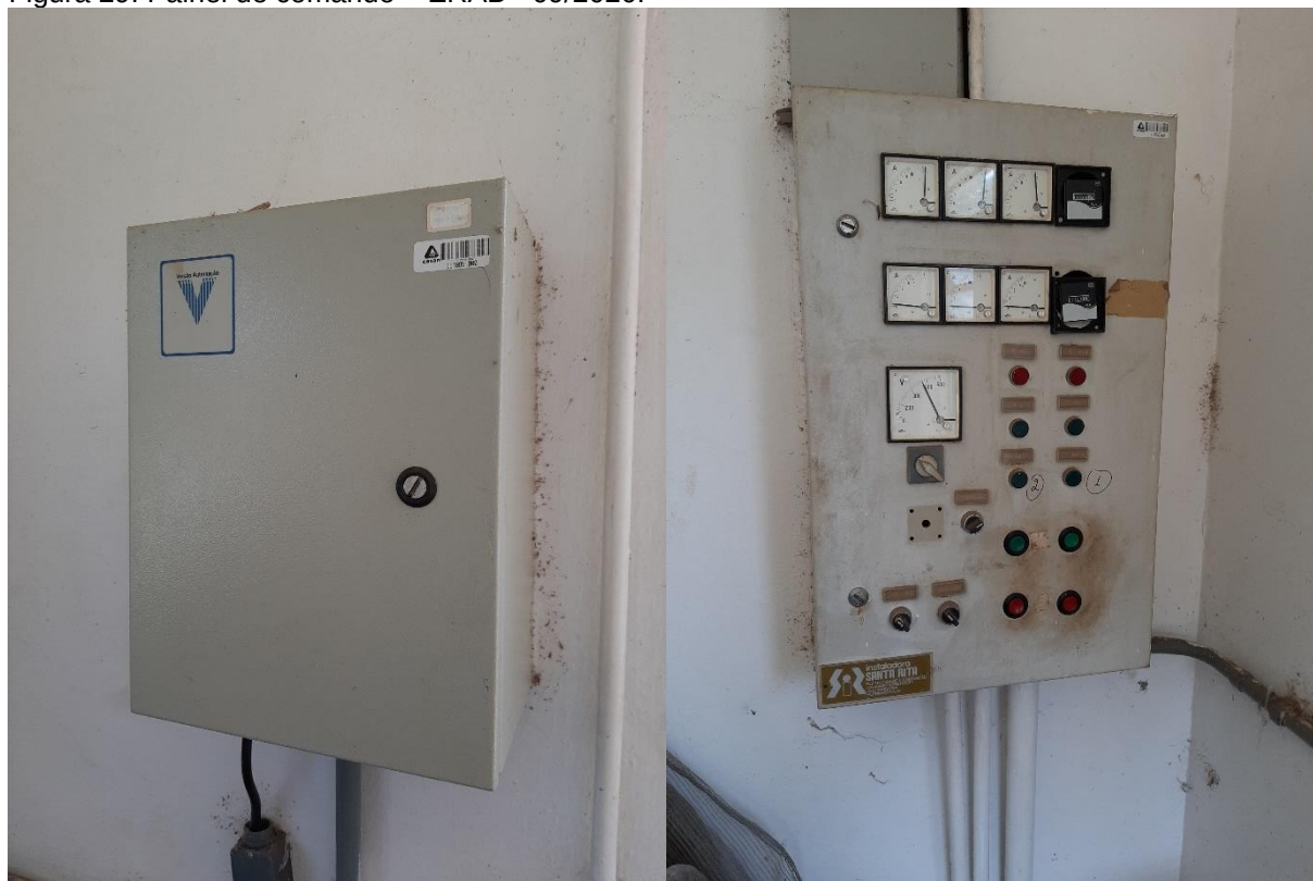
Figura 29: Painel de comando – ERAB - 09/2020.
