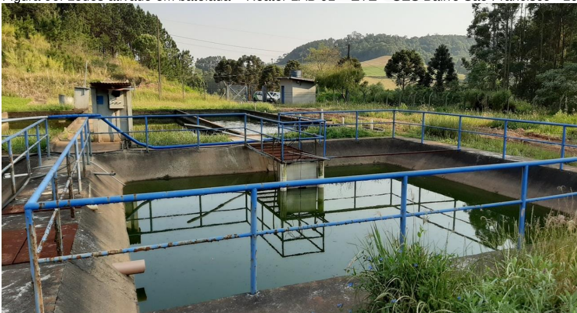
Figura 96: Lodos ativado em batelada – Reator LAB 01 – ETE – SES Bairro São Francisco - 10/2020.
