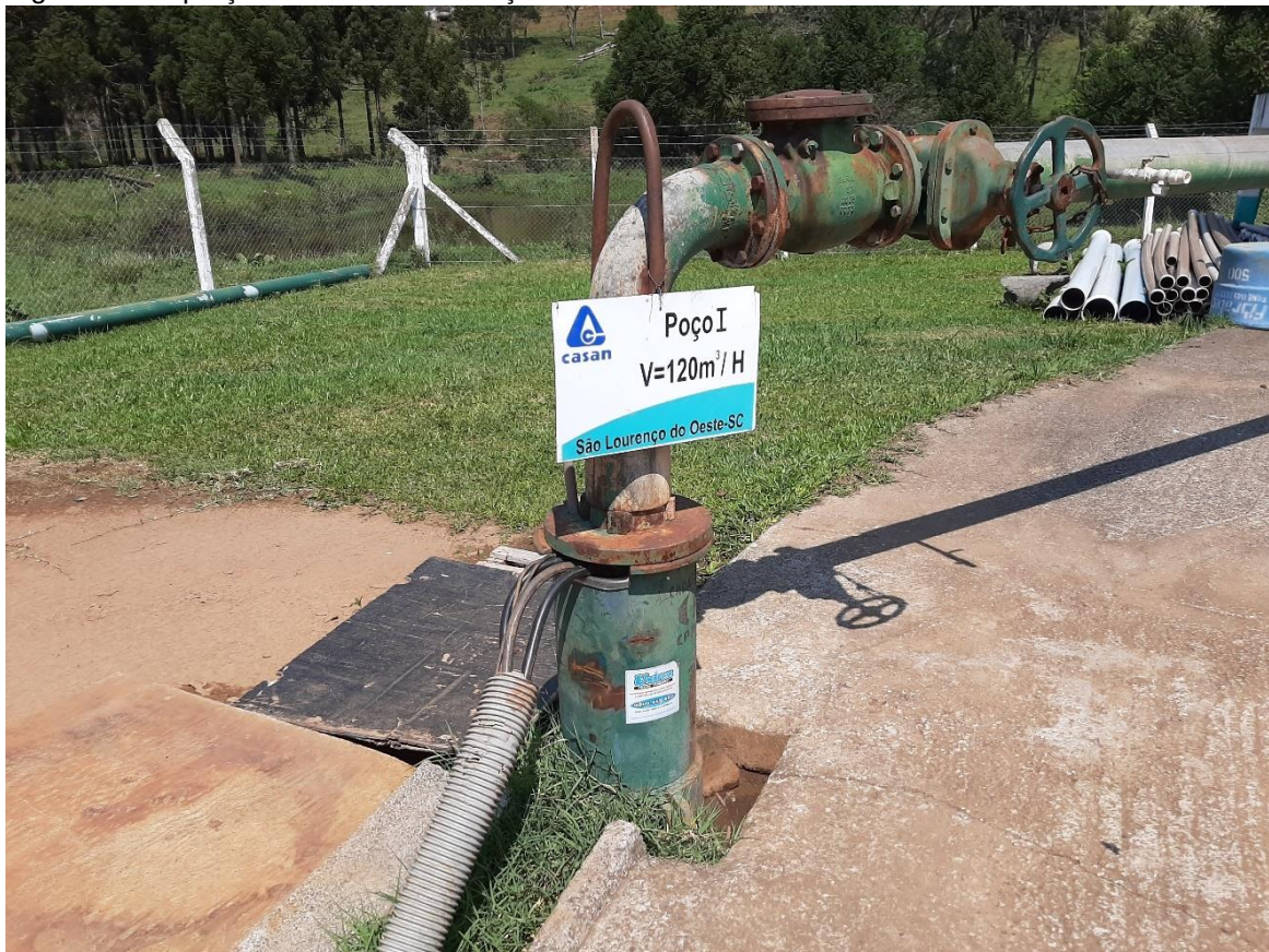
Figura 30: Captação subterrânea – Poço I - 09/2020.
