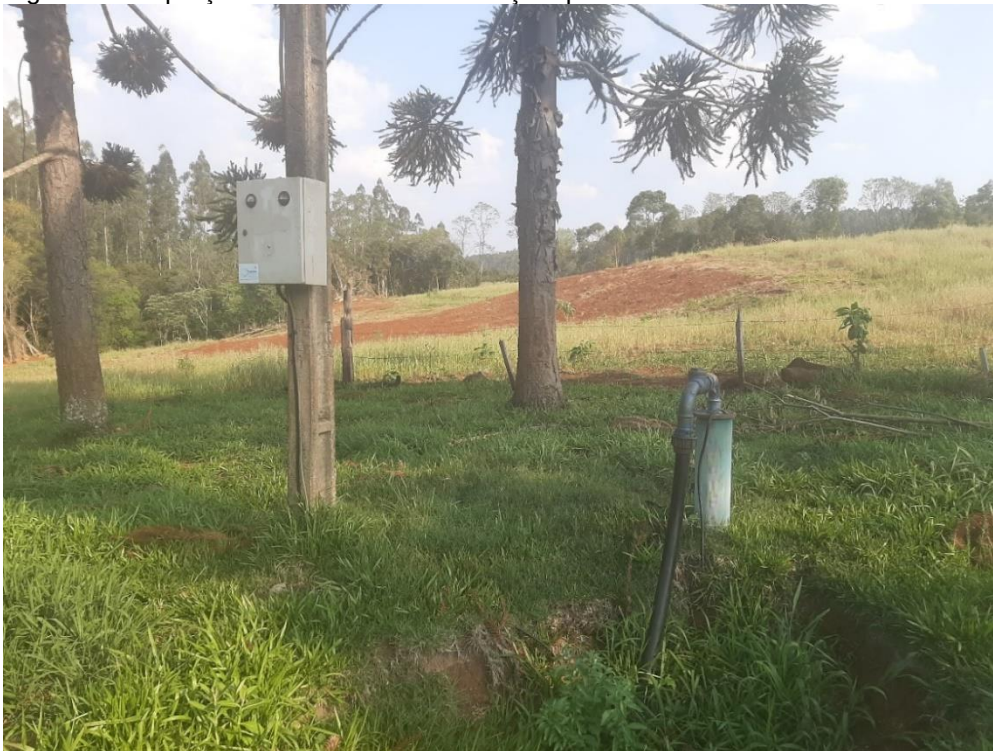
Figura 78: Captação Linha Santa Inês– Poço e painel de comando - 09/2020.
