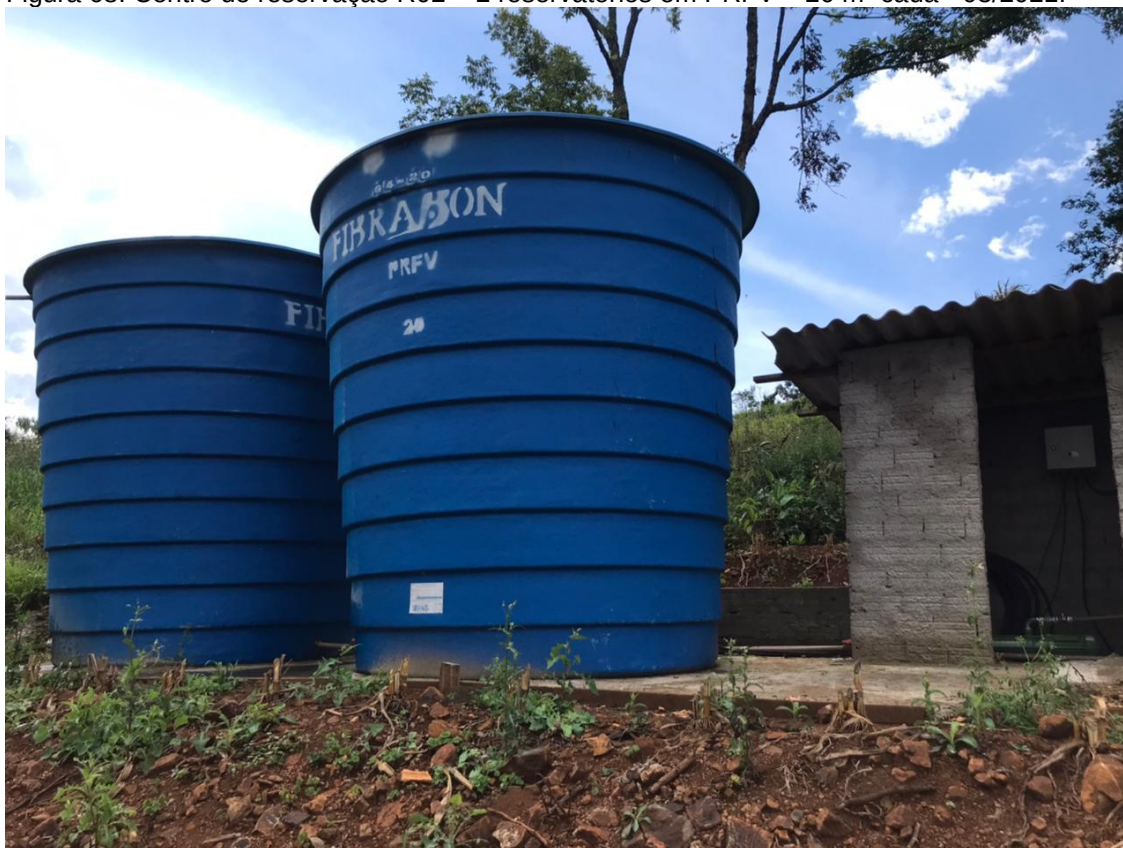
Figura 68: Centro de reservação R02 – 2 reservatórios em PRFV – 20 m³ cada - 03/2021.
