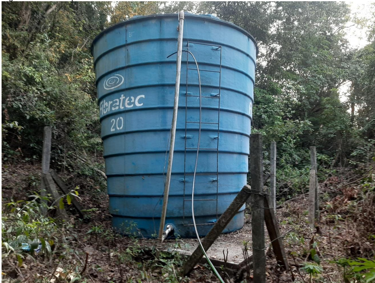
Figura 83: Reservação Linha Giordani – reservatório PRVF 20m³ - 09/2020.
