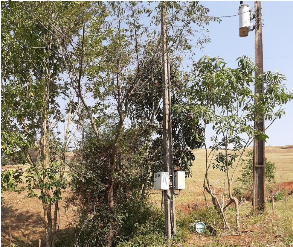
Figura 73: Captação Linha Santana da Bela Vista – Painelelétrico - 09/2020.
