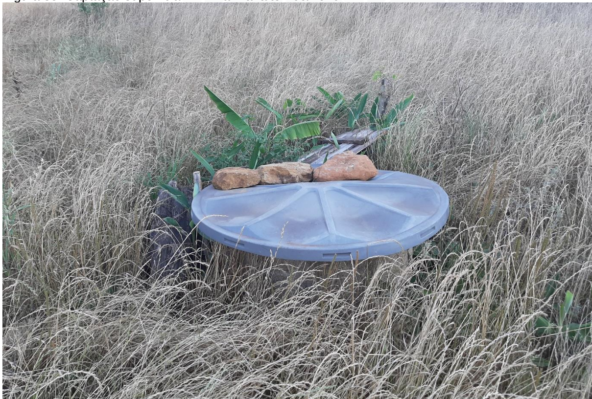
Figura 85: Captação superficial – Linha Planalto - 09/2020.
