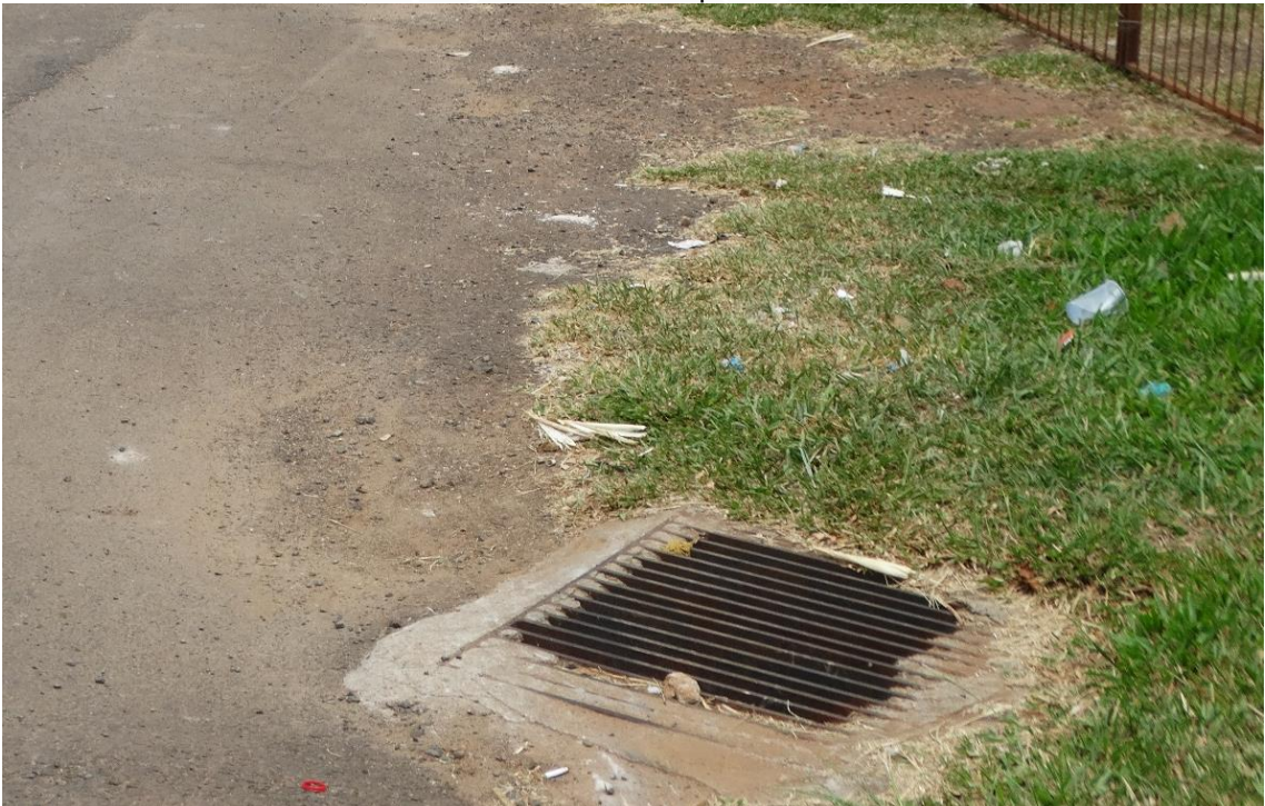
Figura 159: Modelo de boca de lobo instalado no Município - 02/2021.
