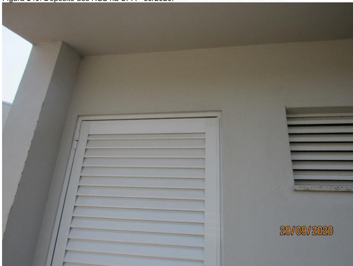
Figura 140: Depósito dos RSS na UPA - 09/2020.
