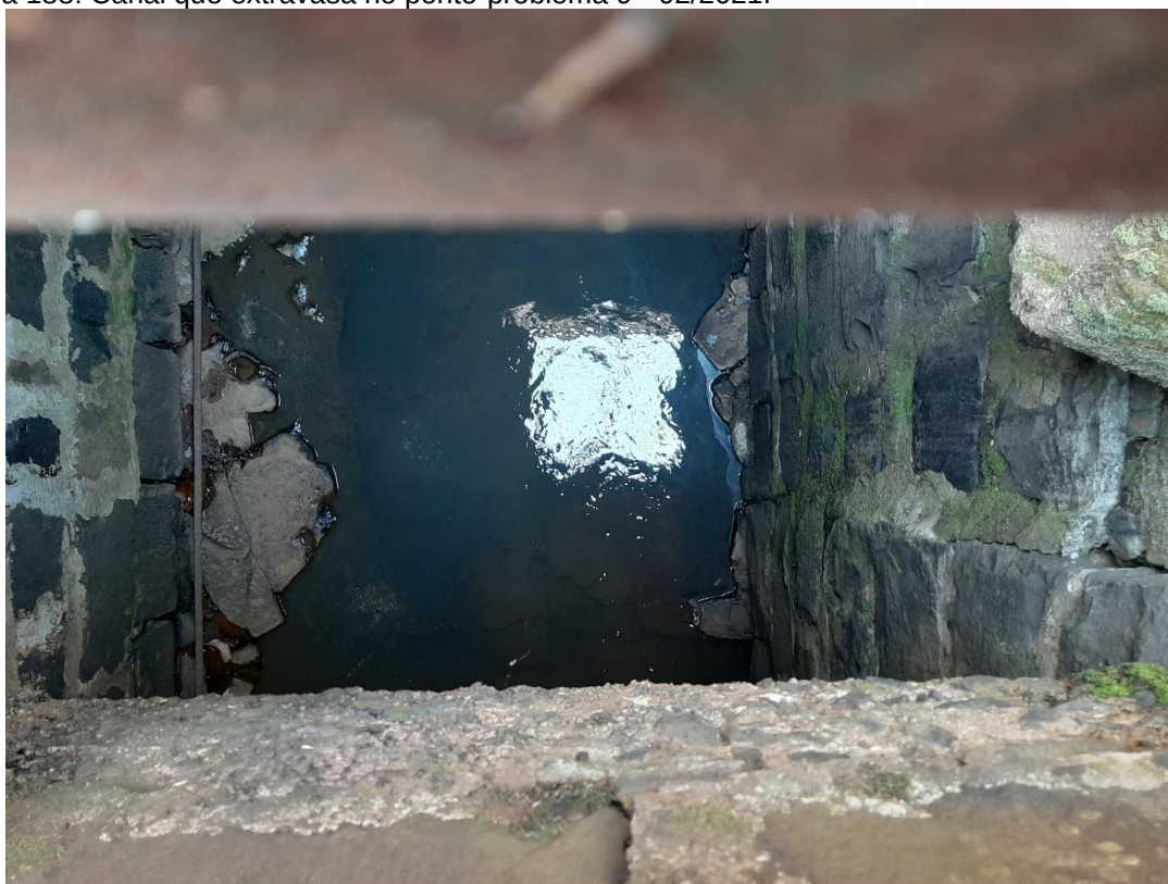
Figura 188: Canal que extravasa no ponto-problema 9 - 02/2021.
