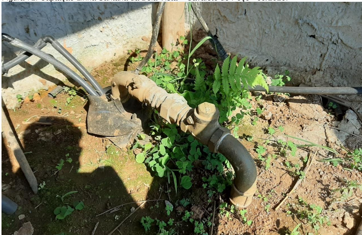
Figura 71: Captação Linha Santana da Bela Vista – Cavalete do Poço - 09/2020.
