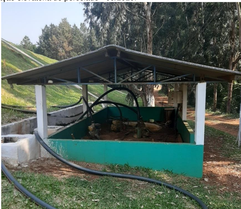
Figura 123: Estação elevatória de percolado - 09/2020.
