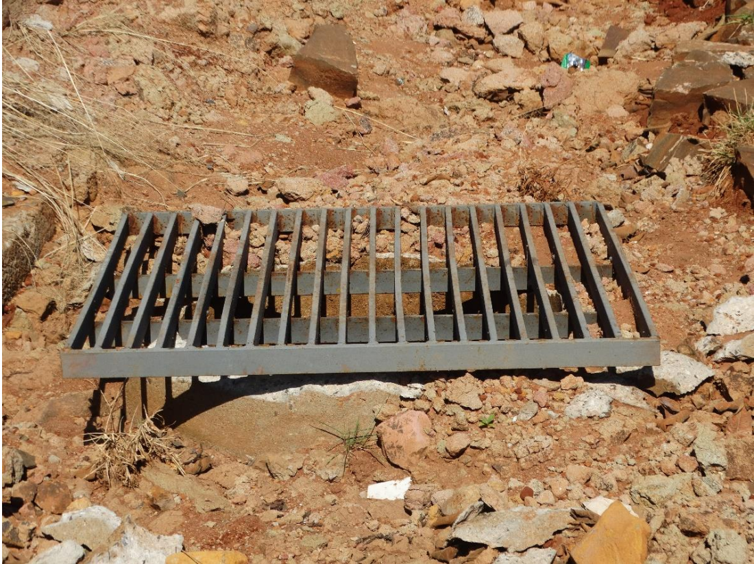
Figura 160: Instalação inadequada da grelha - 02/2021.
