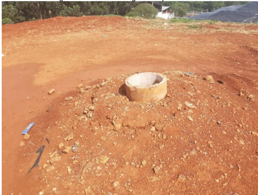
Figura 122: Sistema de drenagem e tratamento de gases implantado no aterro - 09/2020.
