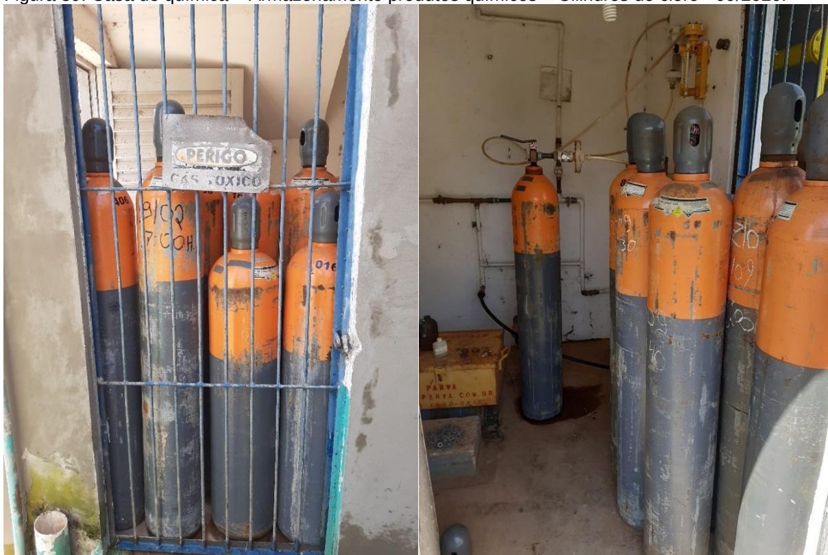
Figura 39: Casa de química – Armazenamento produtos químicos – Cilindros de cloro - 09/2020.
