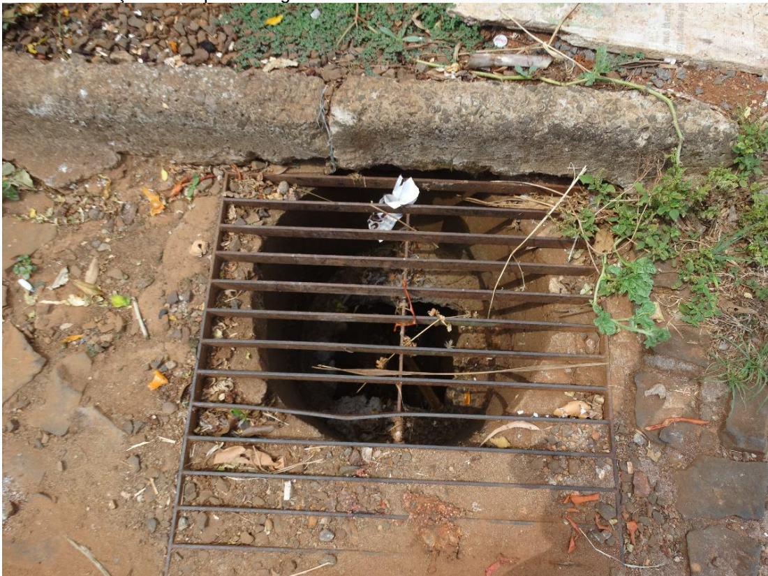
Figura 161: Instalação inadequada da grelha - 02/2021.
