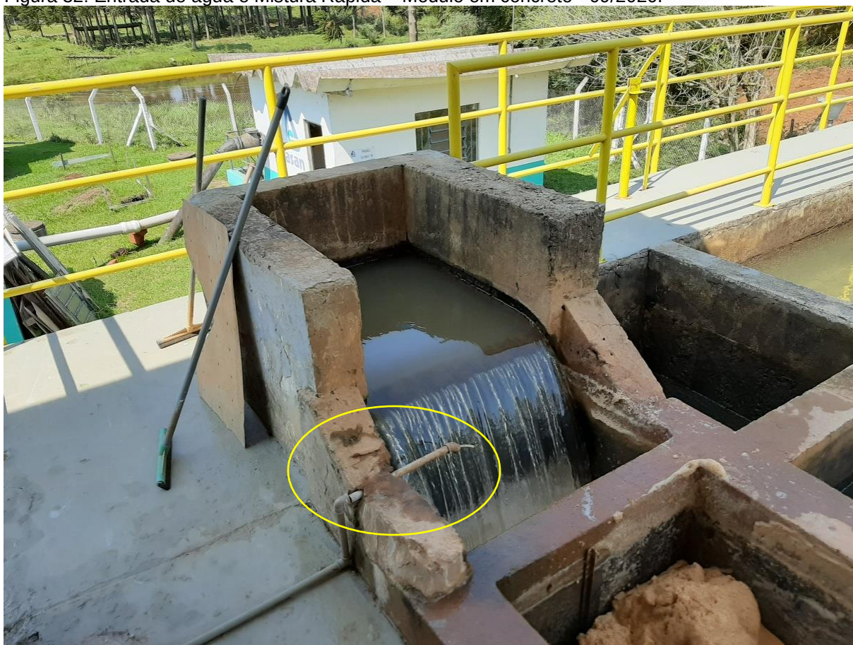
Figura 32: Entrada de água e Mistura Rápida – Módulo em concreto - 09/2020.
