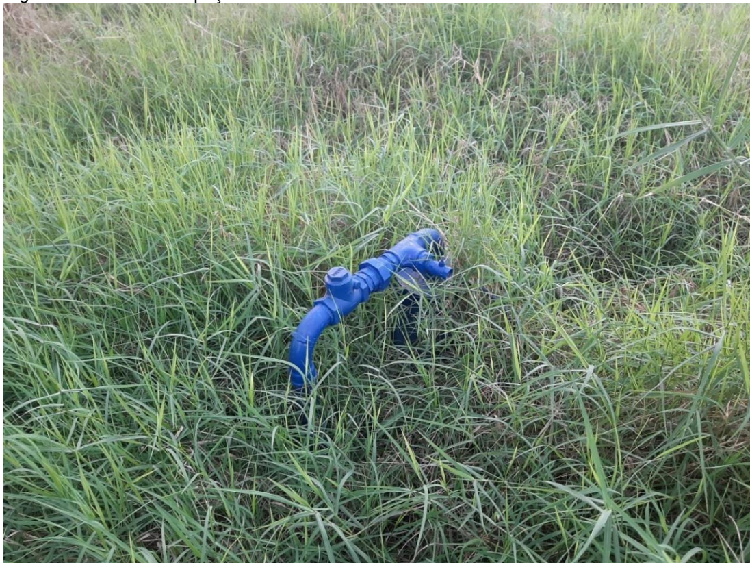
Figura 58: Cavalete do poço – SAA Distrito de Frederico Wastner - 09/2020.
