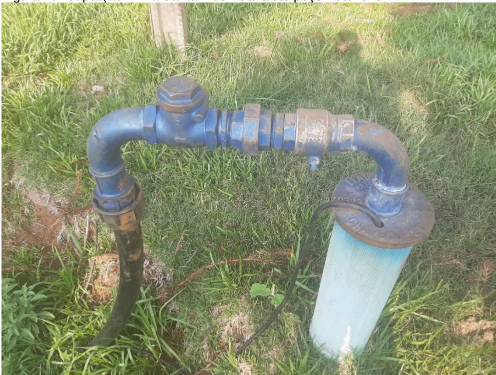
Figura 79: Captação Linha Santa Inês– Cavalete poço - 09/2020.
