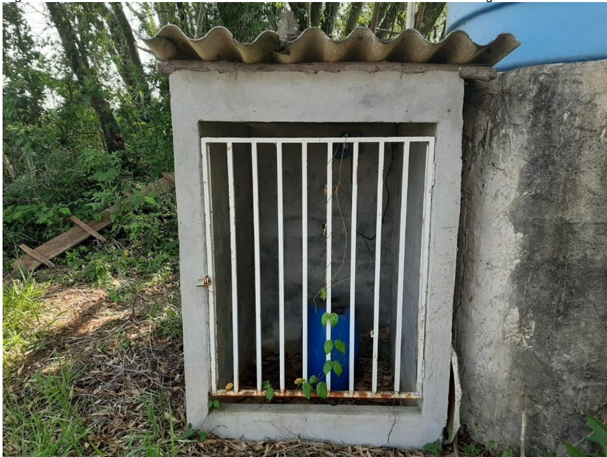
Figura 75: Tratamento – Linha Santana da Bela Vista – Armazenamento e dosagem cloro - 09/2020.
