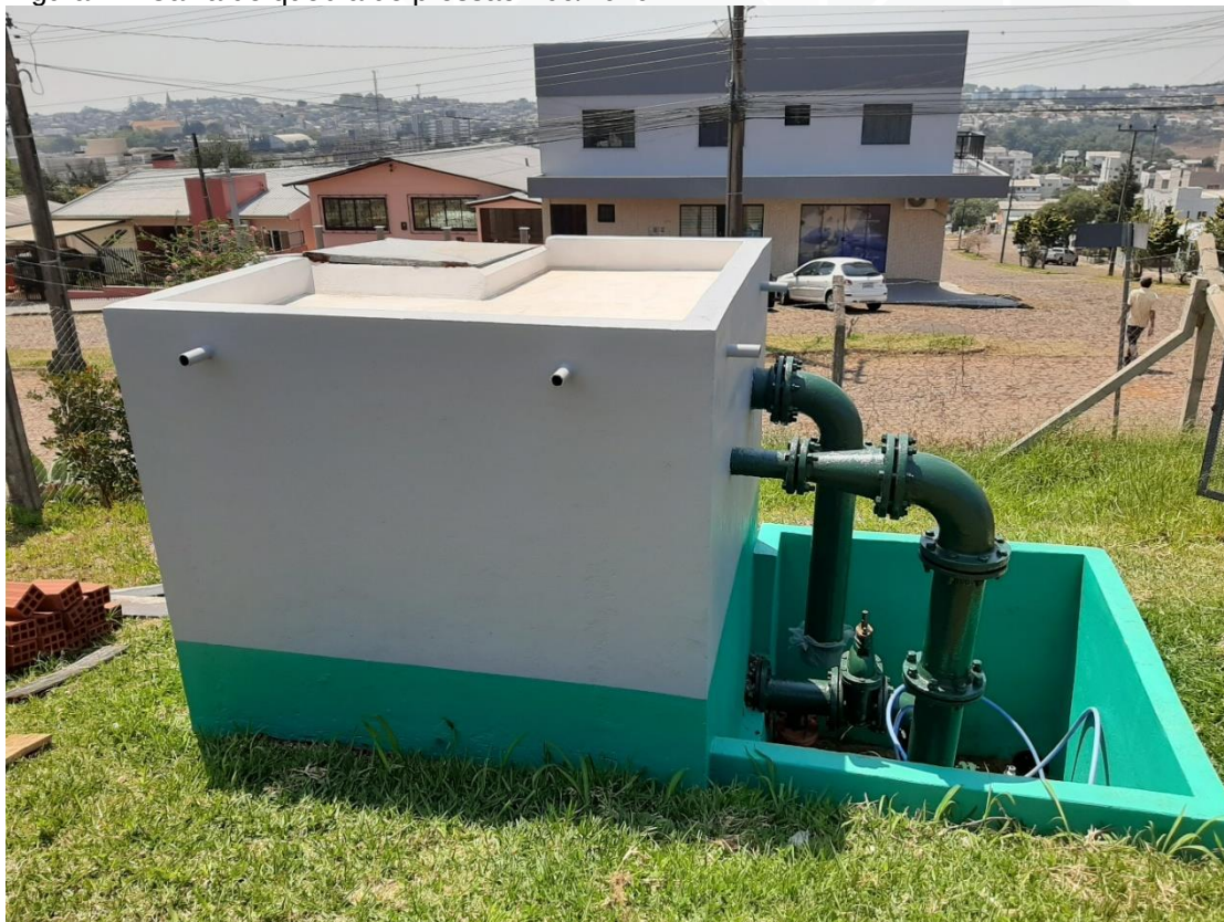
Figura 42: Caixa de quebra de pressão - 09/2020.
