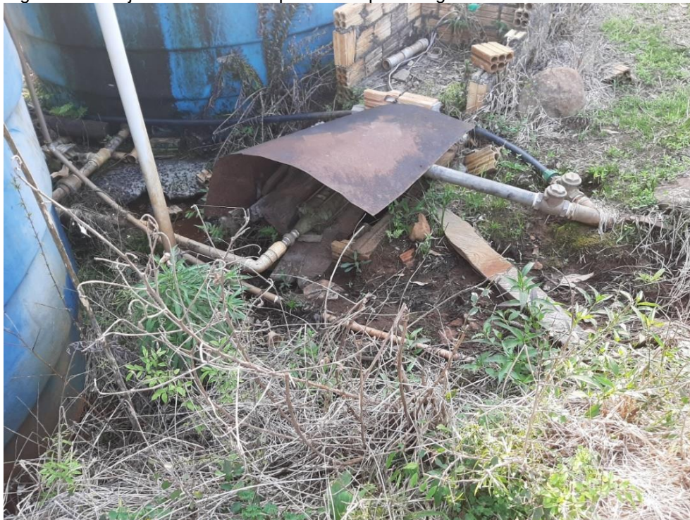
Figura 64: Conjunto motobomba para recalque da água - 09/2020.
