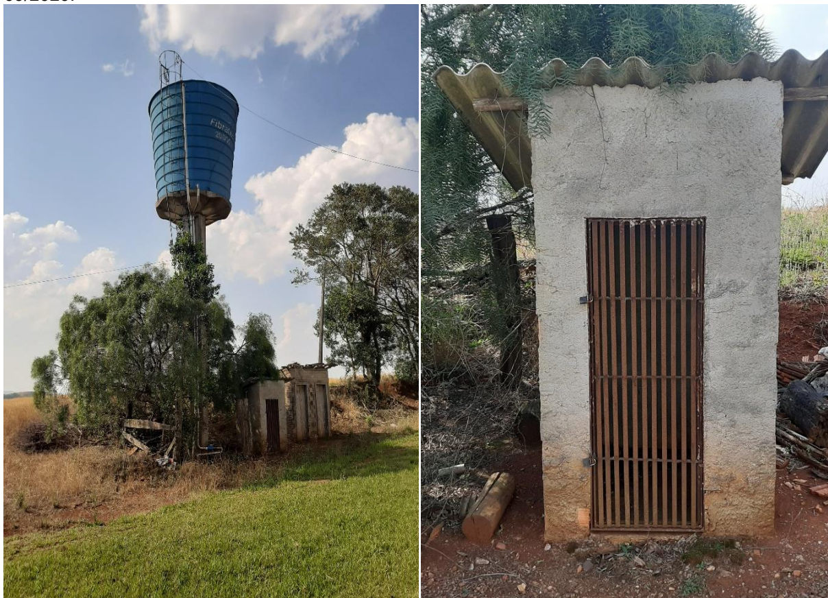
Figura 86: Reservatório em PRFV elevado (20m³) e estrutura para armazenamento de químicos - 09/2020.
