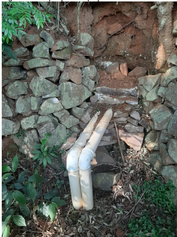
Figura 67: Captação em poço raso - 09/2020.
