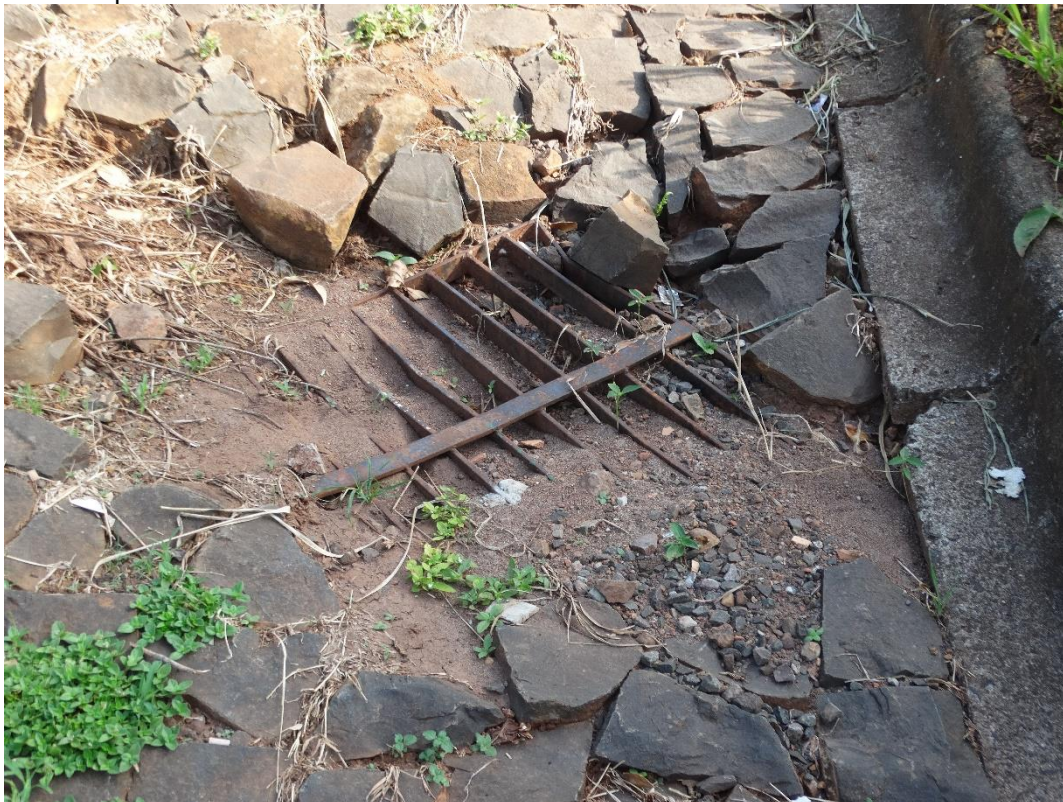
Figura 162: Dispositivo de entrada obstruído.
