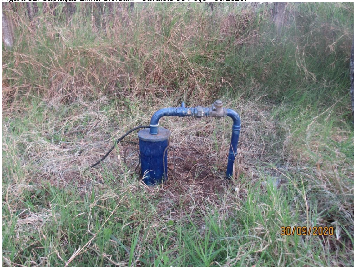
Figura 81: Captação Linha Giordani– Cavalete do Poço - 09/2020.
