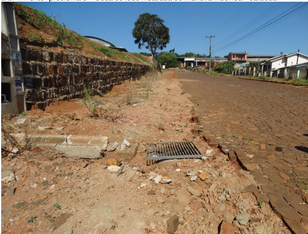
Figura 174: Ponto -problema 3 – Boca de lobo instalada de maneira indevida - 02/2021.
