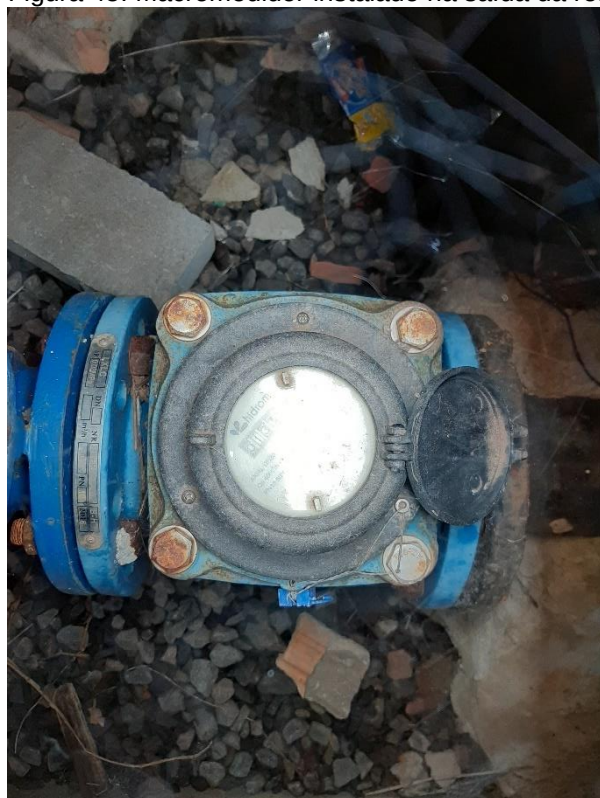
Figura 45: Macromedidor instalado na saída da reservação - 09/2020.
