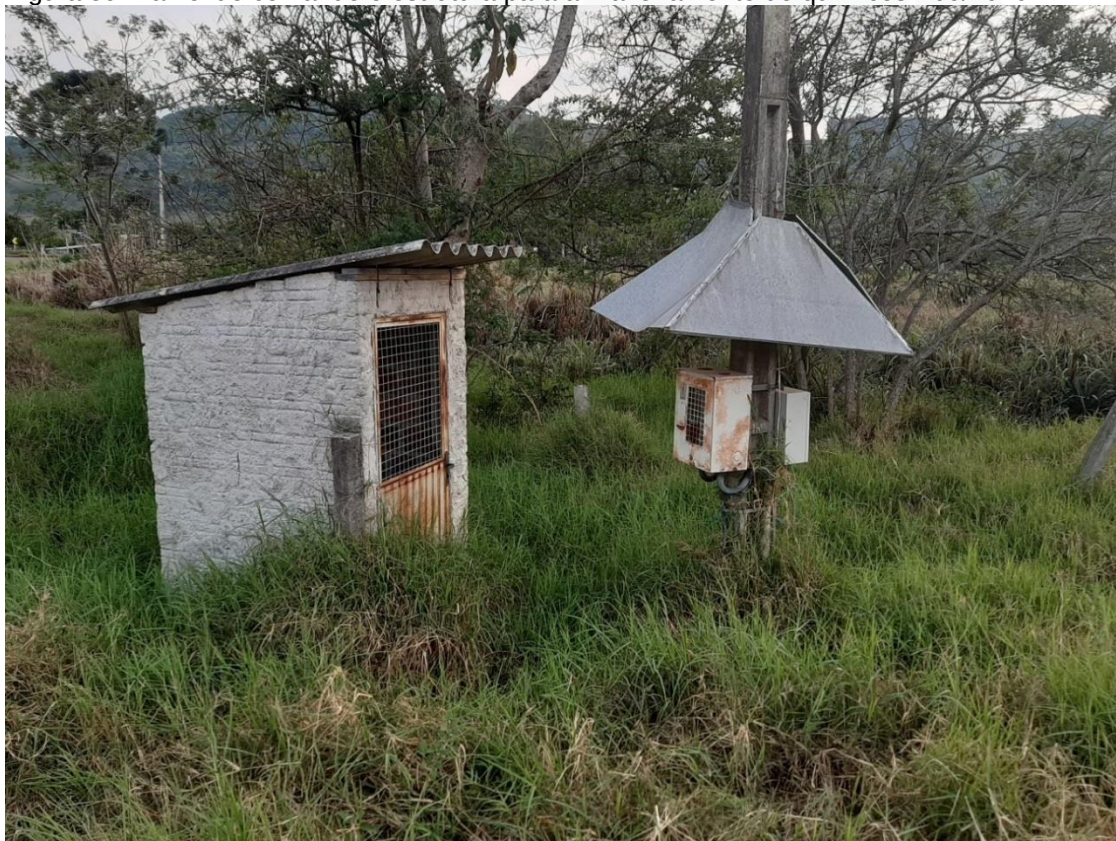
Figura 59: Painel de comando e estrutura para armazenamento de químicos - 09/2020.
