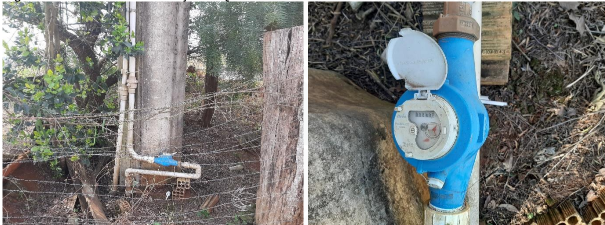
Figura 87: Macromedidor Multijato – QN 10 m³/h - 09/2020.
