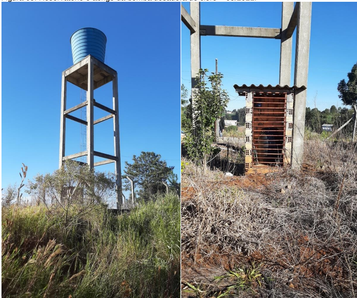
Figura 65: Reservatório e abrigo da bomba dosadora de cloro – 05/2021.
