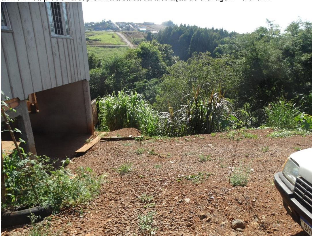
Figura 176: Área-problema 3, próxima a saída da tubulação de drenagem - 02/2021.
