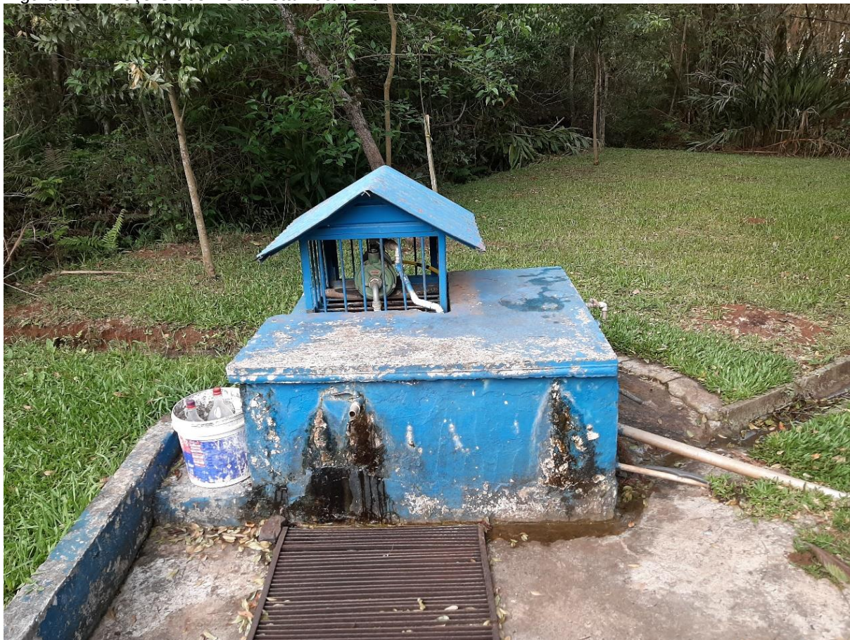
Figura 88: – Poço Clube Bela Vista - 09/2020.
