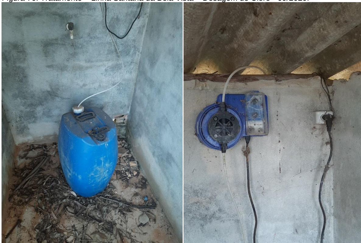
Figura 76: Tratamento – Linha Santana da Bela Vista – Dosagem de Cloro - 09/2020.
