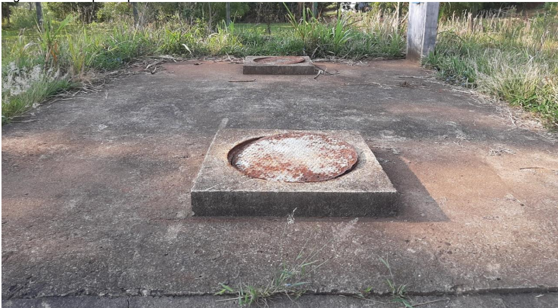
Figura 95: Tanque séptico – ETE – SES Bairro São Francisco - 10/2020.
