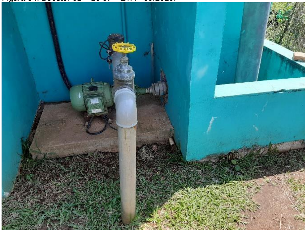
Figura 54: Booster 01 – 10 cv – ETA - 09/2020.
