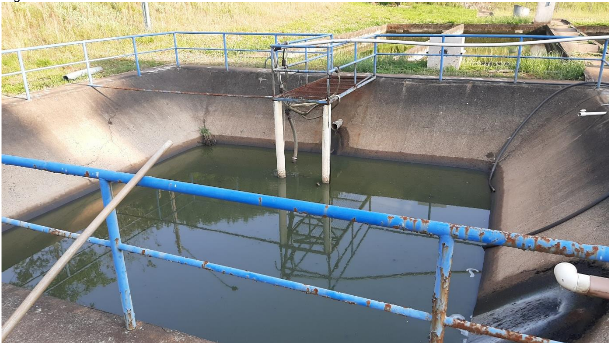
Figura 97: Lodos ativado em batelada- Reator LAB 02 – ETE – SES Bairro São Francisco - 10/2020.
