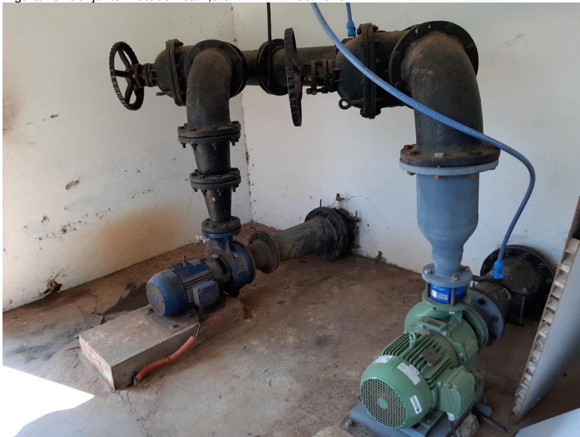
Figura 28: Conjunto motobomba 7,5 cv– ERAB - 09/2020.
