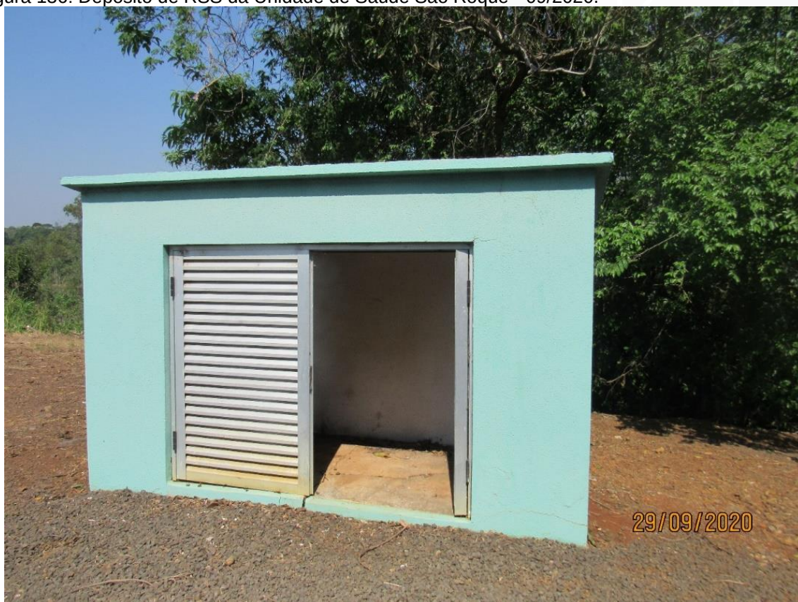
Figura 136: Depósito de RSS da Unidade de Saúde São Roque - 09/2020.
