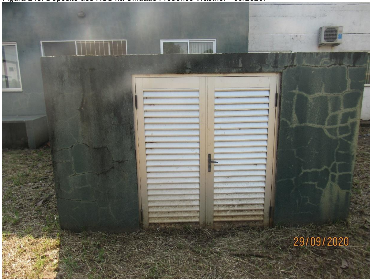
Figura 143: Depósito dos RSS na Unidade Frederico Wastner - 09/2020.
